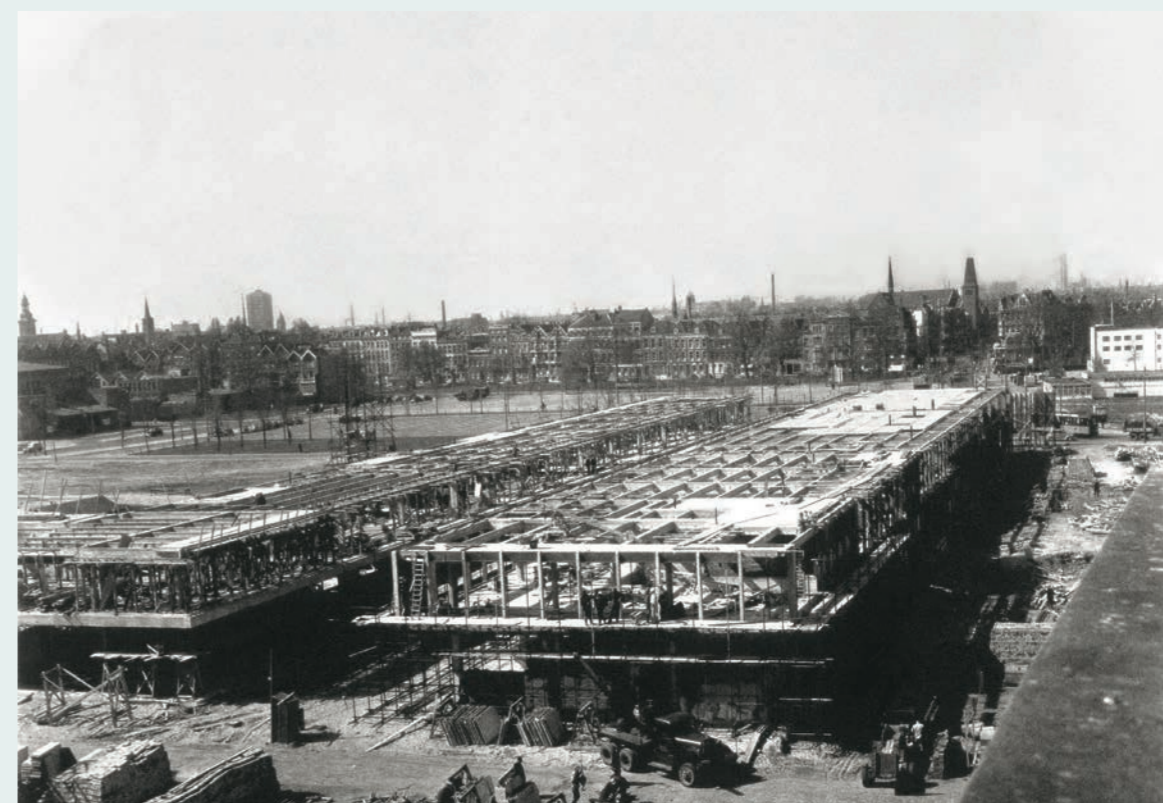
Bouw van de Lijnbaan (1953) — Eén van de bekendste projecten die Dura tijdens de wederopbouw van Rotterdam bouwt, is de bouw van de Lijnbaan, de twee kruisende wandelstraten met 66 winkels. Als er negen panden zonder koper blijven, biedt Job Dura aan deze voor eigen rekening en risico te bouwen en ter verhuur aan te bieden. Het is één van de eerste vormen van projectontwikkeling in de geschiedenis van het bedrijf. Driehonderd Dura-arbeiders werken ruim vijftien maanden dag in dag uit aan de Lijnbaan.
