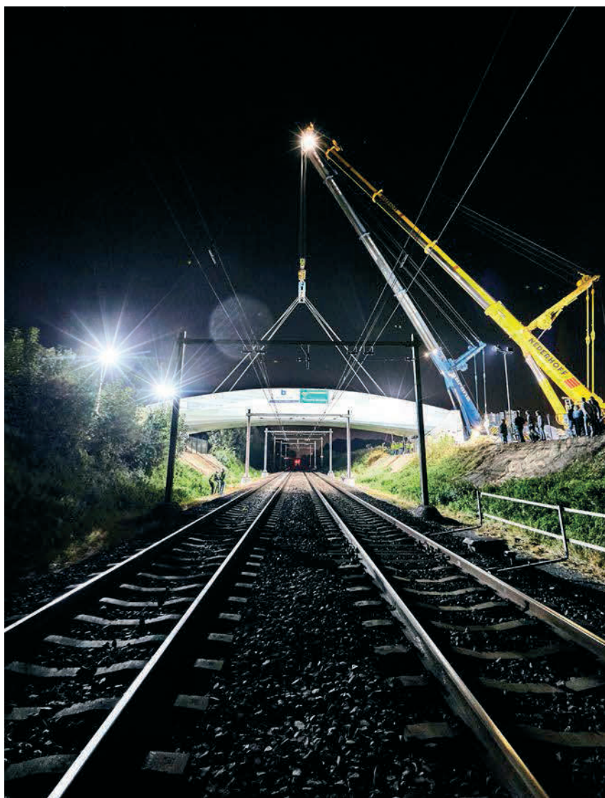
Fietspad en fietsbrug Spoorzone Sittard Bijzonderheden tender op basis van EMVI. Technisch complex als gevolg van 'zandloperige' vormgeving. Inzet 3D modellering met oog op kostenbeperking. Brug over in gebruik zijnd spoor. Opdrachtgever Gemeente Sittard-Geleen
